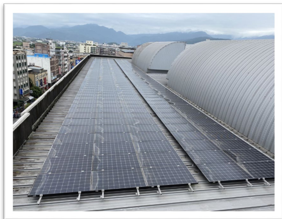
▲樓頂太陽能板
