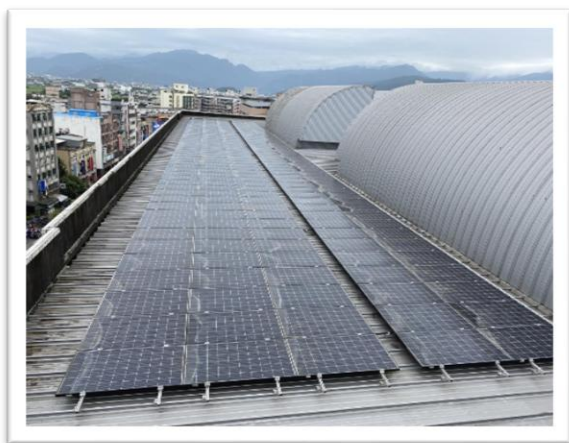
▲樓頂太陽能板
